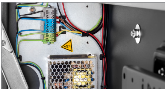
fachgerechte Verkabelung und Absicherung nach VDE (E-Check)
