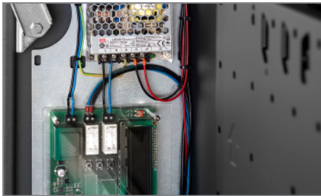
Verkabelung nach VDE-Richtlinien
