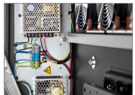
fachgerechte Verkabelung nach VDE
